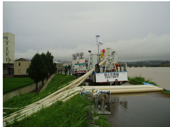
川田川樋管排水ポンプ車
