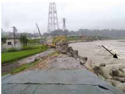
204.8km の堤防決壊状況
