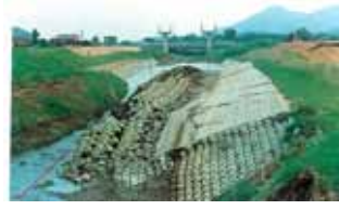
【盛土による滑り破壊の状況】
