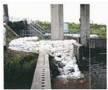
樋門部からの漏水事例
