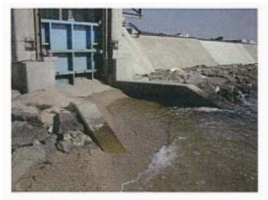
樋門吐口の土砂堆積状況
