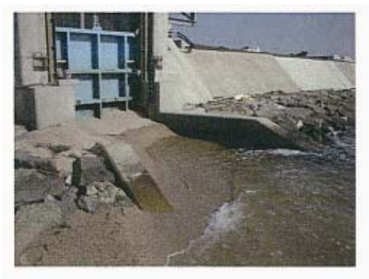
樋門吐口の土砂堆積状況
