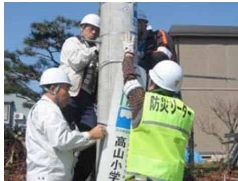
避難誘導標識の設置
