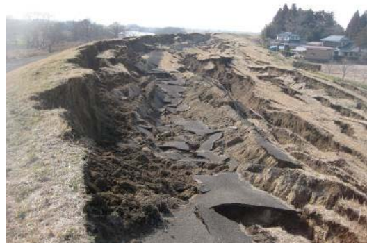
地震による堤防の被災
