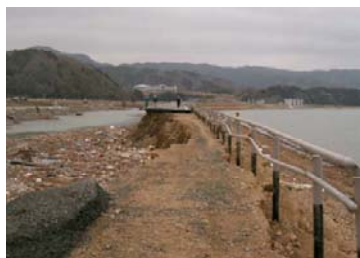
津波により堤防が被災
