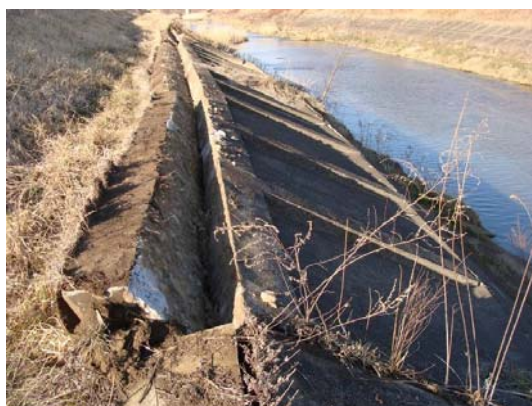
阿武隈川右岸 61.0k 付近 (東根川地先) ※地震による護岸破壊
