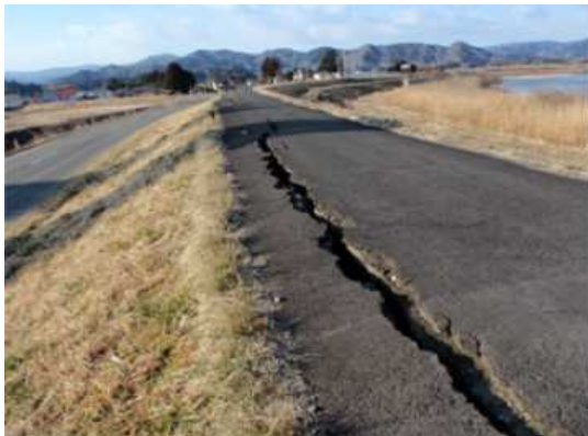
阿武隈川右岸 33.0k 付近 (丸森町小斉地先) ※地震による堤防亀裂
