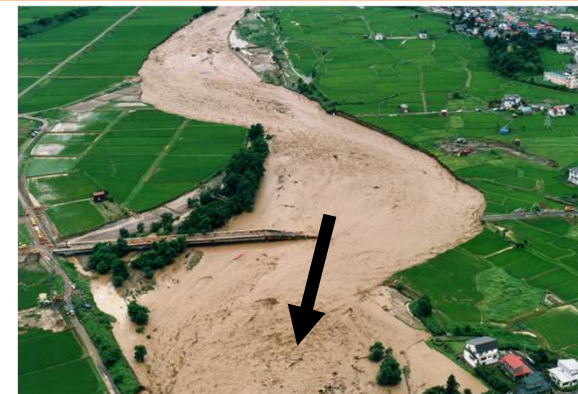
妙高市 新保橋 落橋
