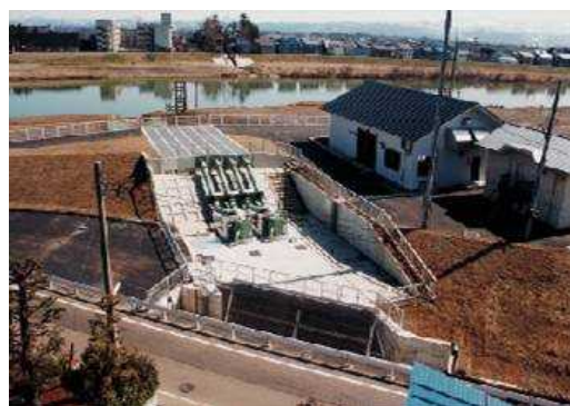
すいどがわ 水戸の川排水機場
