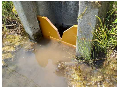
田んぼダム調整板設置状況
