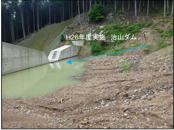
平成30年豪雨時 治山ダム満砂状況
