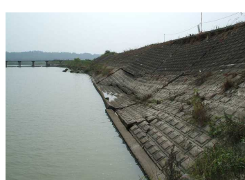
河床低下による護岸崩壊等
