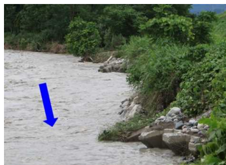
天竜川左岸 151.4k 付近 護岸一部流出
