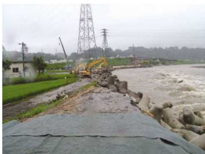
204.8km の堤防決壊状況
