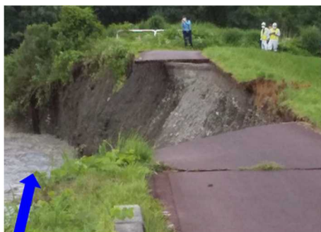
三峰川右岸 4.6k 堤防の欠損
