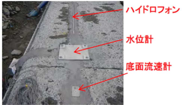
流砂観測施設
