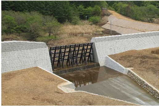
藤沢水無 鋼製スリット型砂防堰堤 (H23年度完成)(三峰川流域)
