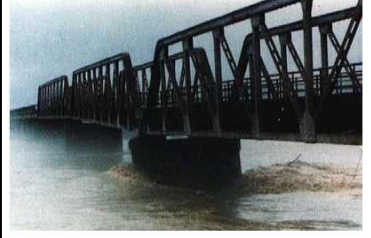
福井市高屋付近高屋橋(県道福井三国線)の橋脚が洗掘のため傾いた
