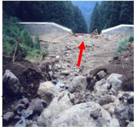
平成16年8月 (土石流発生後)
