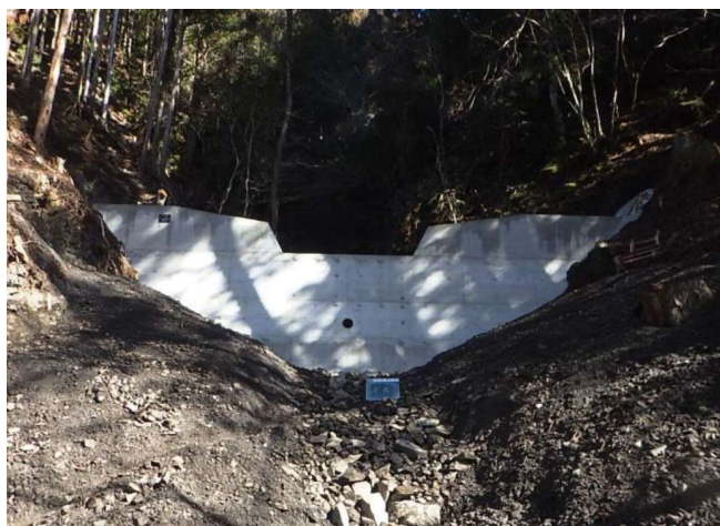
図 2 - 4 治山施設（大谷谷止工 令和 3 年（2021 年）完成）
