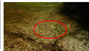
30m³/s放流後に見られた砂による削り跡
