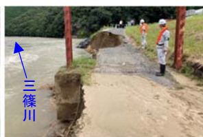
三篠川 右岸 4.2k 堤防一部欠損 L=30m
