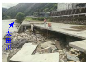
太田川 右岸 33.8k 護岸崩落 L=20m
