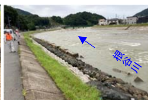
根谷川 左岸 4.0k 方塊ブロック流出 L=120m
