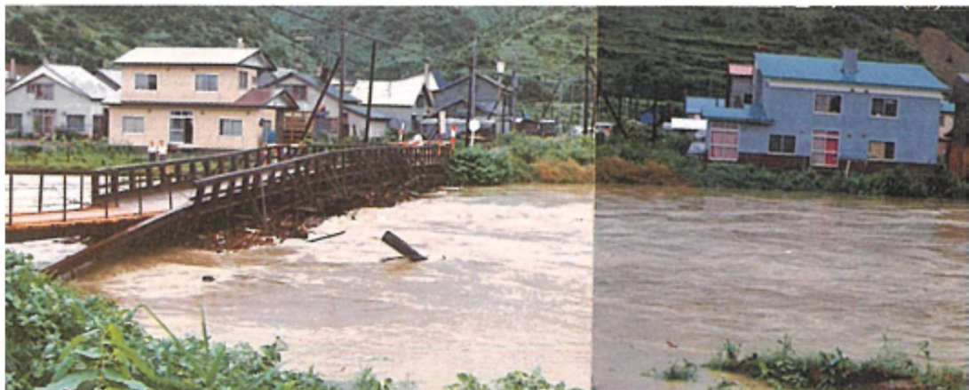
落橋寸前の大通り橋
