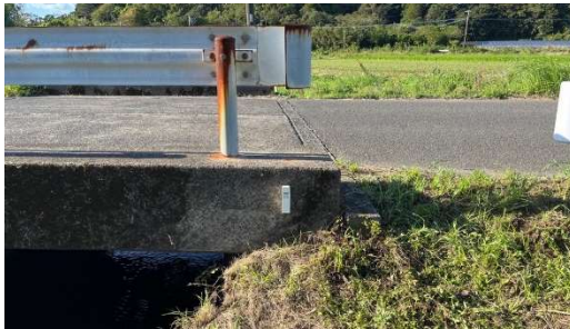
写真 4-19 ワンコイン浸水 センサ設置状況
