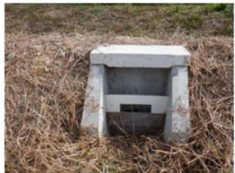
田んぼダムの排水柵
