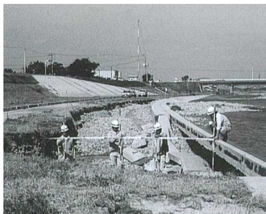
河岸被災状況
