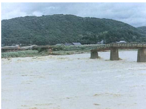
旧乙井橋（11.6k 付近）流出
