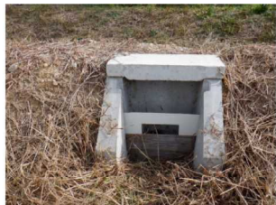
田んぼダムの排水樹
