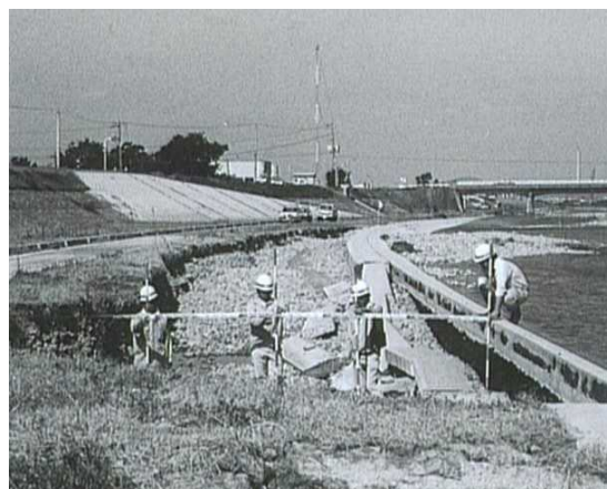
河岸被災状況
