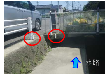
浸水センサ設置状況
