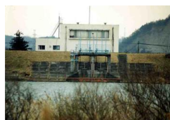
中山揚水機（旧北上川）
