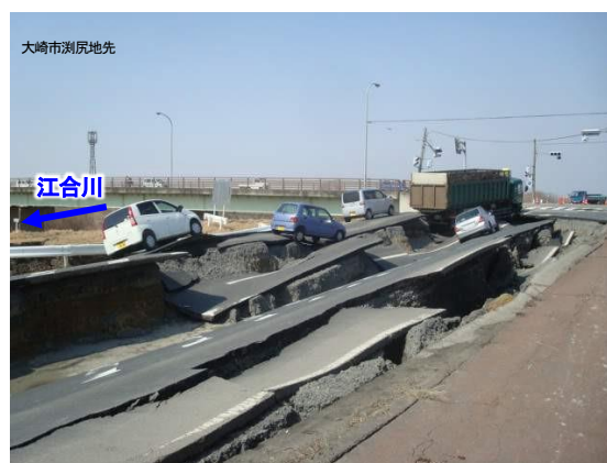
江合川左岸 27.6k 付近 (大崎市古川瀧尻地先) ※地震により縦断クラック発生
