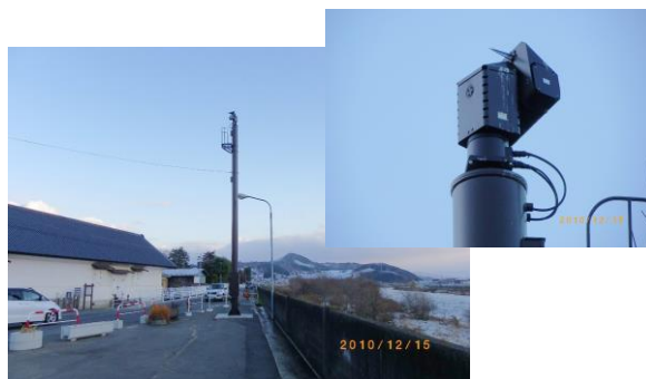
CCTV カメラ（明治橋）
