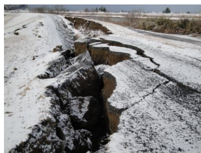
【鳴瀬川】堤防被災状況
