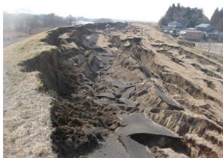
【鳴瀬川】堤防被災状況
