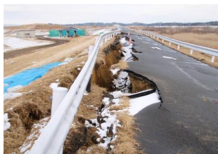
【吉田川】堤防被災状況
