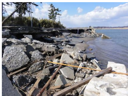
【鳴瀬川】堤防被災状況
