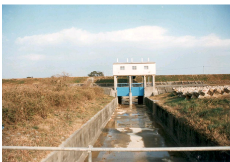
うおみ 魚見用水樋管
