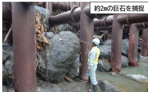
図 2-4 砂防堰堤の施設効果 (ますだま 舂玉第2砂防堰堤)
