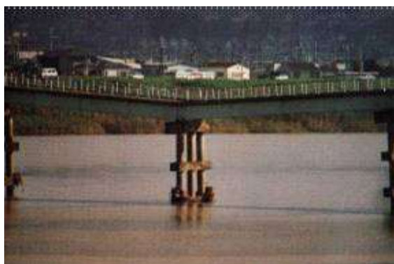
南海橋の陥没被害
