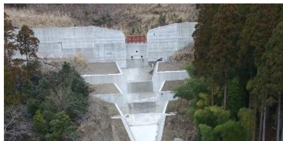
図 2-4 砂防堰堤整備（宮崎県）
