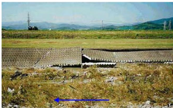
平成10年9月洪水による低水護岸の被災(香美市岩積地先)
