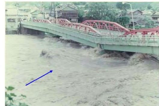
昭和47年7月洪水による下流部香我美橋の橋梁の被災(香美市神母ノ木地先)
