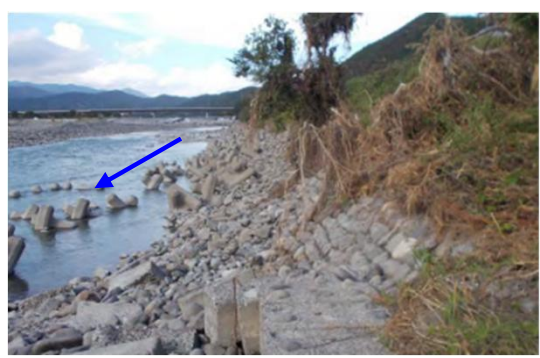
平成30年7月洪水による低水護岸の被災(香美市町田地先)
