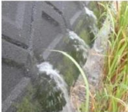
漏水（箇所③）
