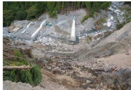
④ 治山ダムの被災状況
