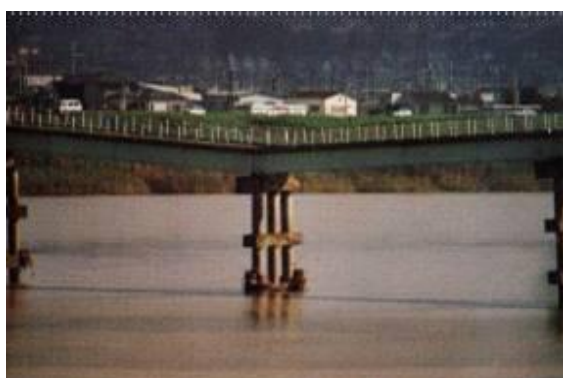
南海橋の陥没被害
