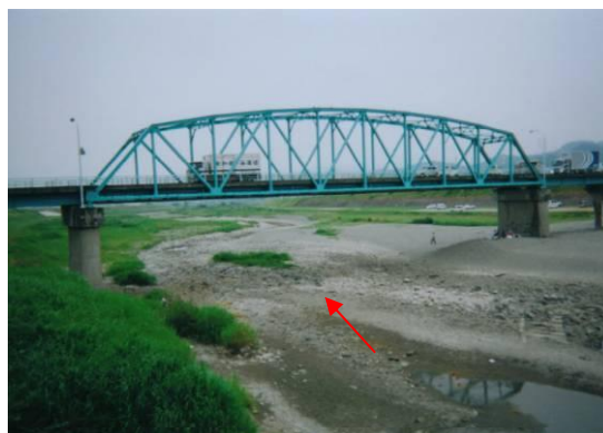
貴志川の瀬切れの状況(平成 14 年(2002 年)6 月諸井堰)
