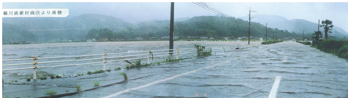
写真 4-5 湧水町の浸水状況（旧吉松樋寄川右岸地区）
