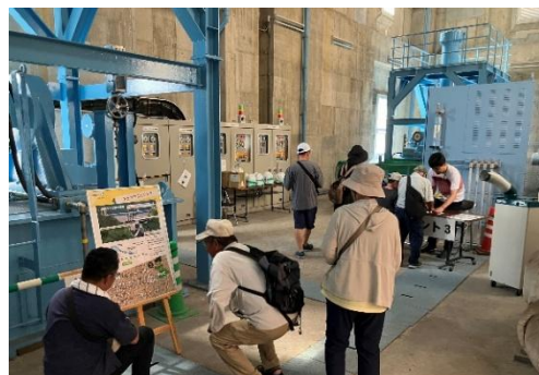
常用放流設備ゲート室
