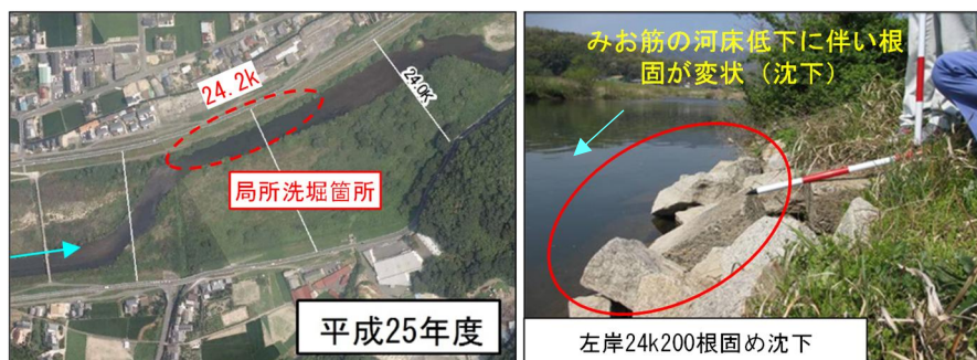
図 4-10 局所洗掘による根固め工の変状事例
