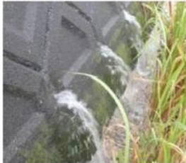
漏水（箇所③）
