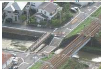
三河橋落橋(竜泉寺川)
