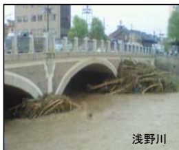
浅野川大橋の流木堆積状況(金沢市)
