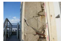
水門の門柱部のコンクリ剥離
