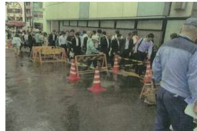
H26.5 下水管渠の腐食に伴う道路陥没・溢水(新宿区)
