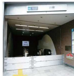
出入口の止水板
