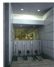
ビルの出入口の止水板
