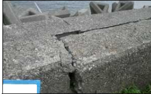
海岸堤防の損傷
