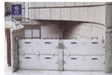
浸水対策の例： 止水板（脱着式）の設置
