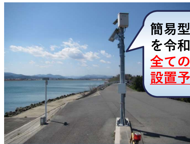
簡易型河川監視カメラ
