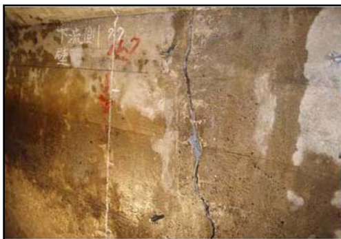
樋門函体のクラック
