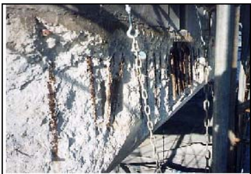
堰本体の鉄筋露出
