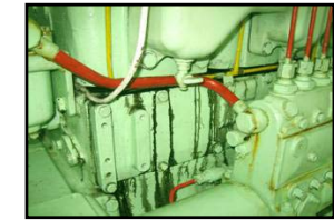
ポンプ原動機のオイル漏れ
