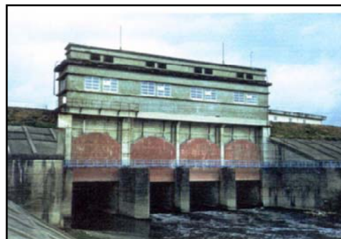
樋門の老朽化
