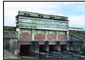
樋門の老朽化
