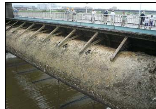
堰ゲートの腐蝕
