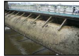
堰ゲートの腐蝕
