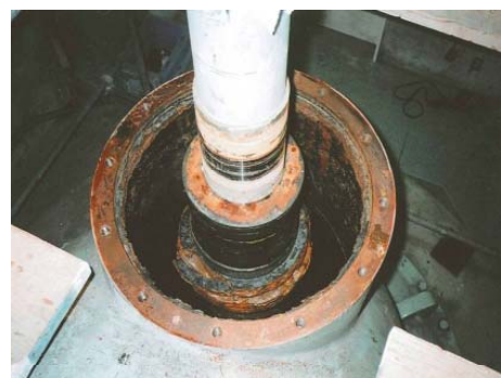
ポンプ主軸パッキンの摩耗
