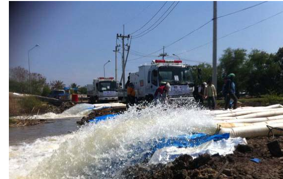
派遣した排水ポンプ車
