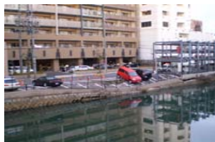
鋼矢板護岸の損壊状況
