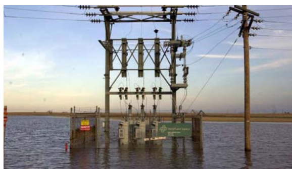
2005 年ハリケーン・カトリーナ 水害による電力施設の損傷 28)
