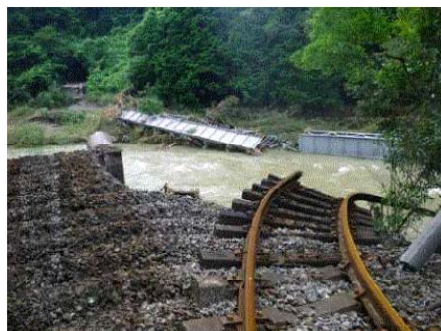
平成 22 年豪雨による J R 美祢線の橋梁流出状況 114)
