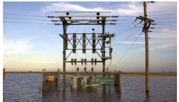
浸水による電力施設の損傷
