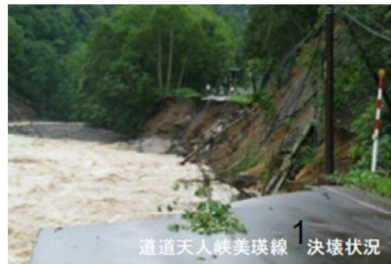
平成22年豪雨による道路寸断状況
