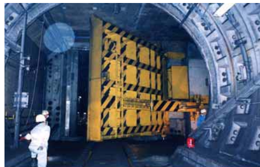
トンネル内浸水対策 105) (防水ゲート)
