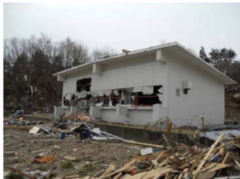
津波により被災した通信設備
